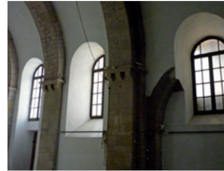
Les travaux de restauration du XVII e siècle, visibles dans le percement de ces fenêtres, ont été réalisés par les ateliers de Guillaume Jeaugeon et Jean Perret
